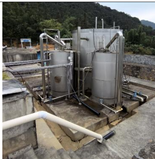
现状一体化净水设施
